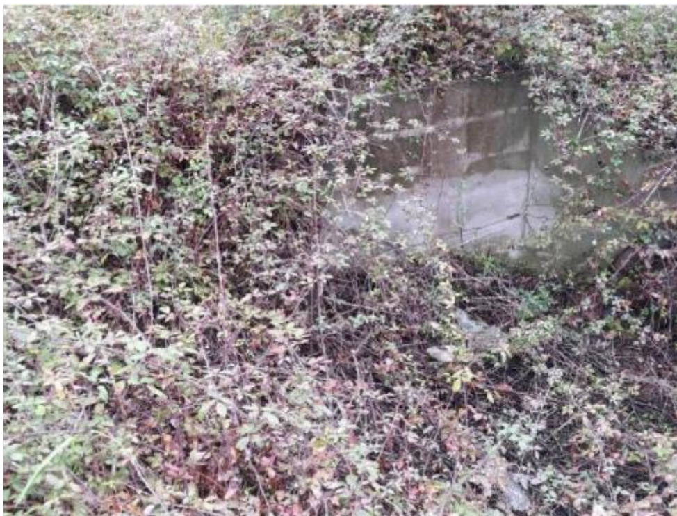
Figura 9 - Passagem hidráulica obstruída por vegetação
